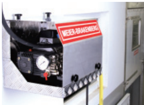
Stationär verlegte Strom- und Wasseranschlüsse für den Hochdruckreiniger machen das umständliche Arbeiten mit langen Schläuchen und Kabeln überflüssig.
